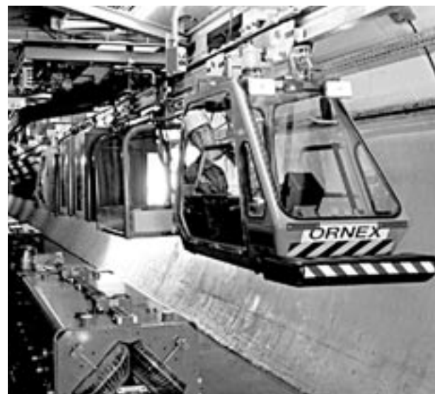
Interior del túnel donde estaba situado el LEP y donde se está instalando el LHC. / EL DÍA
